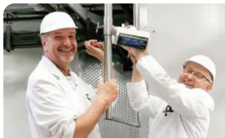
Installation der Box für KI-unterstützte Prozesse im Betrieb. Foto: SLA
